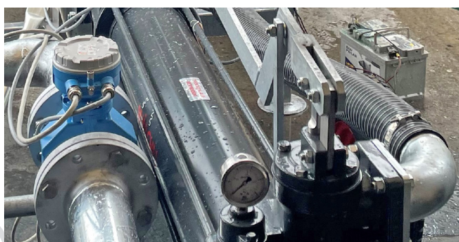
Durchflussmessgerät auf Pumpe
