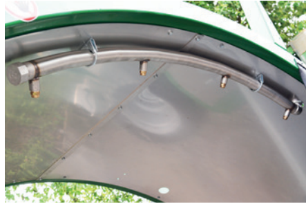
Bewässerungsanschluss mit Verteildüsen. Für die Erreichung eines optimalen Mikroorganismus-Klimas innerhalb der Miete ist die Zugabe von Wasser unerlässlich.
